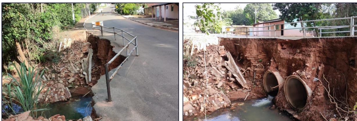
Figura 55 - Ponte situada na Rua Goiandira sobre o Córrego Barreiro e processo erosivo.
