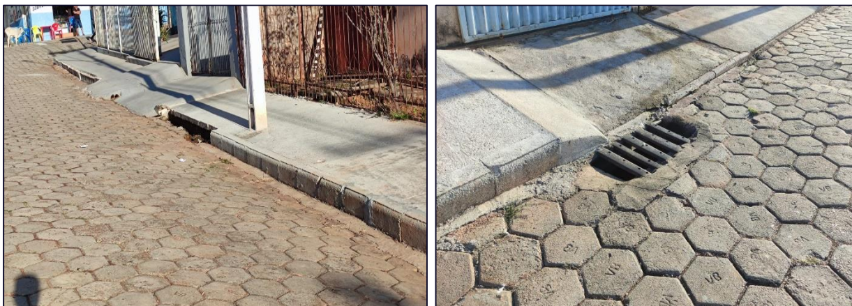
Figura 54 - Dispositivos de microdrenagem na Rua Boa Vista a esquerda e na rua Santo Antônio a direita.
